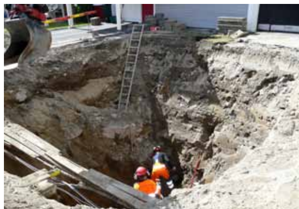
Det är inte alltid ledningarna ligger på 2–3 meters djup. Här låg de på cirka 5 meters djup.
